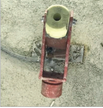
Resim-22 Kabin altı hareketli tampon montajı uygunsuzluğu
