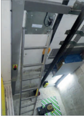
Resim-3 Kuyu iniş merdiveni örneği (kılavuzlu ve elektriksel denetimli)
