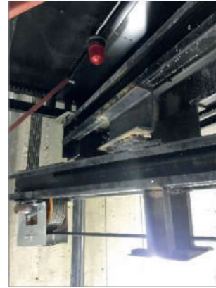
Resim-30 Kabin altı çarpma plakası montajı uygunsuzluğu
