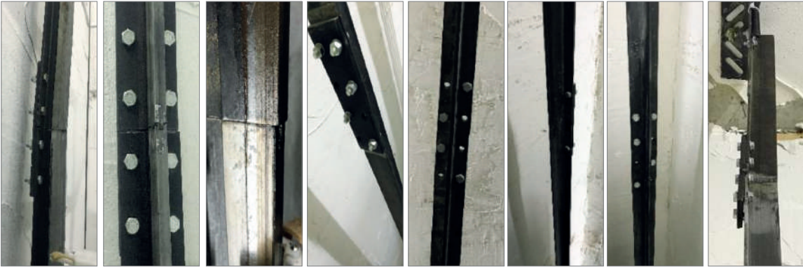
Resim-5 Kılavuz ray bağlantılarındaki hatalı montaj uygulamaları
