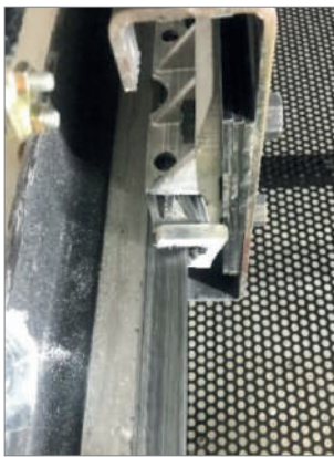
Resim-25 Kabin altı paten montajı uygunsuzluğu
