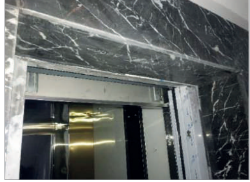
Resim-28 Kat kapı ile kabin kapı yüksekliğinin uyumsuzluğu uygunsuzluğu
