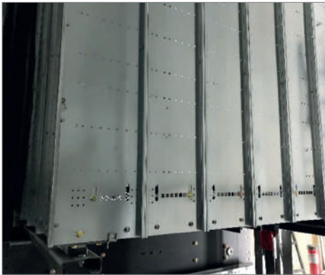
Resim-15 Kabin panel bağlantı sabitlemelerinin yapılmaması
