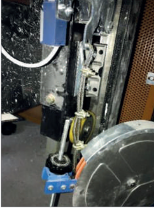
Resim-27 Kabin altı paraşüt bağlantı montaj uygunsuzluğu
