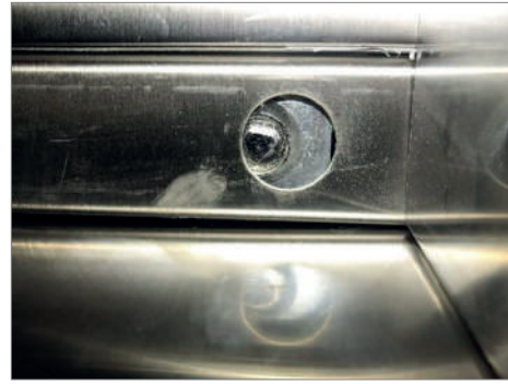
Resim-4 Kat kapı kilit anahtarının kasaya uyumsuzluğu
