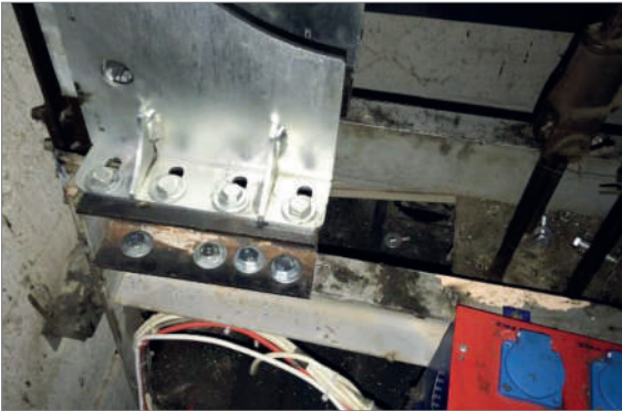
Resim-31 Kabin üstü ilave güvenlik tertibatı imalat hatalı montajı
