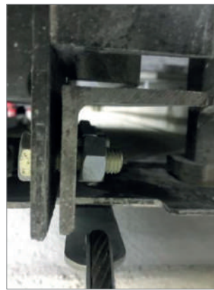
Resim-26 Kabin dikme bağlantı montajı uygunsuzluğu
